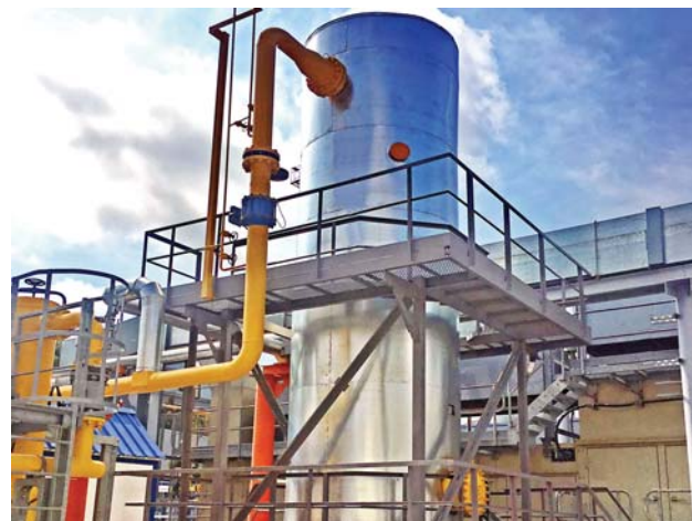
Фото 10. Газовый ресивер объемом 25 куб. м
