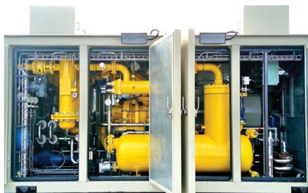
Фото 4. Газокомпрессорное оборудование в составе стенда ПАО «ОДК–УМПО»
