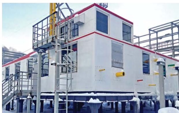
Фото 5. МПТГ-1 установлен на площадке УКПГиК Восточно-Уренгойского лицензионного участка
