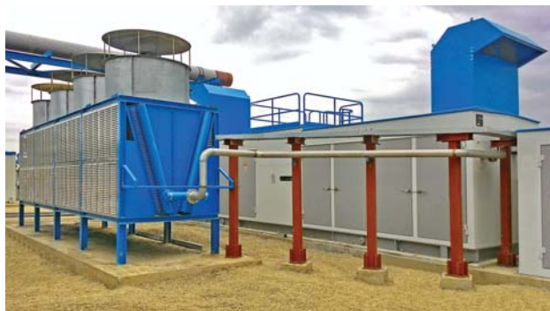
Фото 7. Блок-модуль с технологическим оборудованием и аппарат воздушного охлаждения КУ
