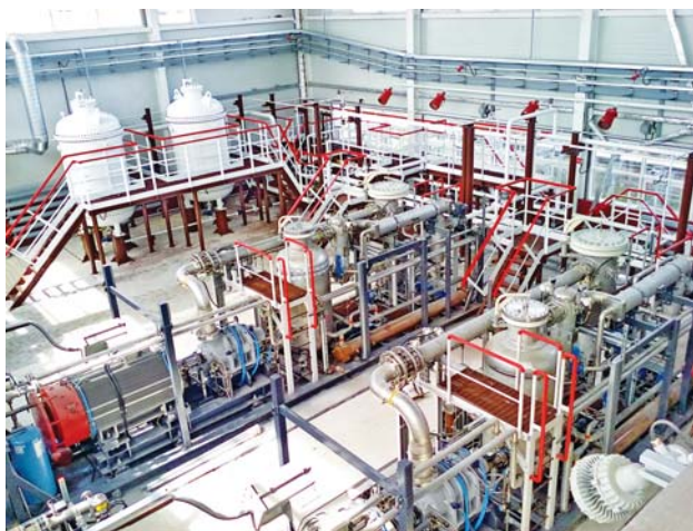
Фото 11. Компрессорные установки снабжают попутным газом Южно-Нюрьмскую ГТЭС
