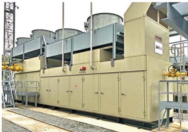
Фото 9. Двухступенчатая установка в составе ДКС топливного газа для ТЭЦ «Восточная»
