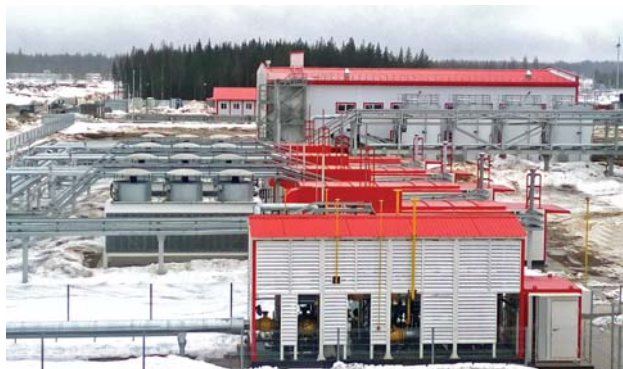
Фото 2. Система газоподготовки и газоснабжения «ЭНЕРГАЗ» для энергоцентра «Ярега»
