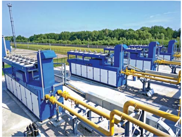
Фото 14. ДКС из четырех установок входит в состав системы комплексной подготовки газа
