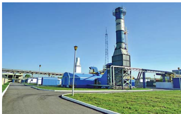
Фото 3. Испытательный стенд газотурбинных двигателей АЛ-31СТ
