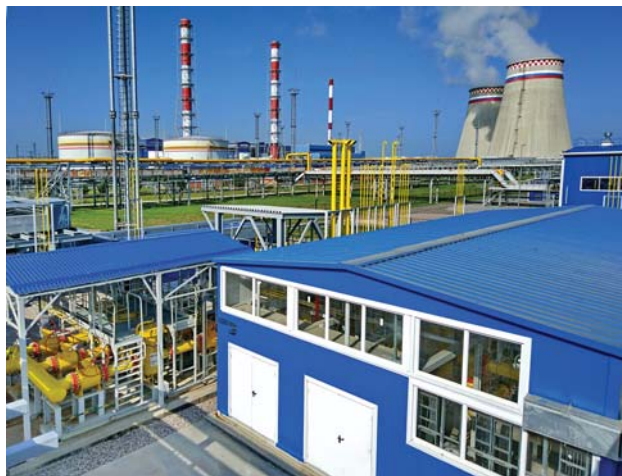
Фото 13. ППГ обеспечит топливом энергоблоки Прегольской ТЭС в Калининграде
